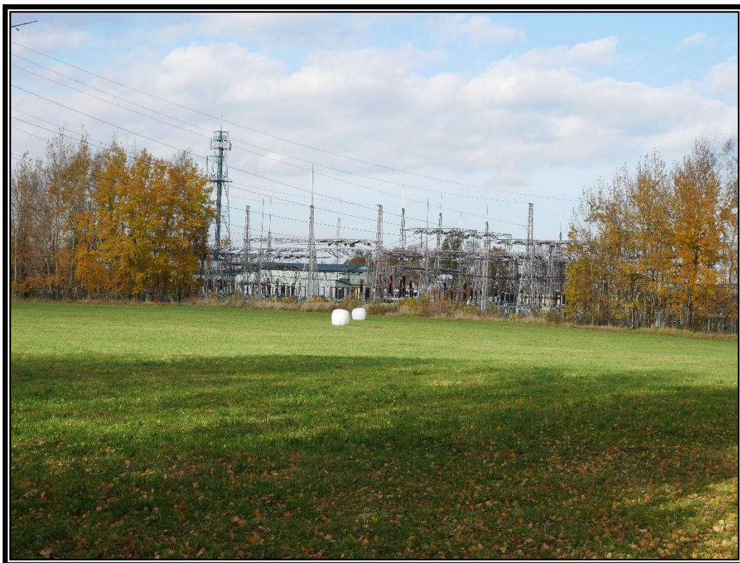
Fotografia 34 – Stacja elektroenergetyczna w Bielsku-Bialej Komorowicach
